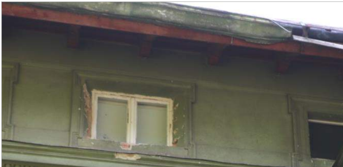
okno v podkroví , poškozený okap
