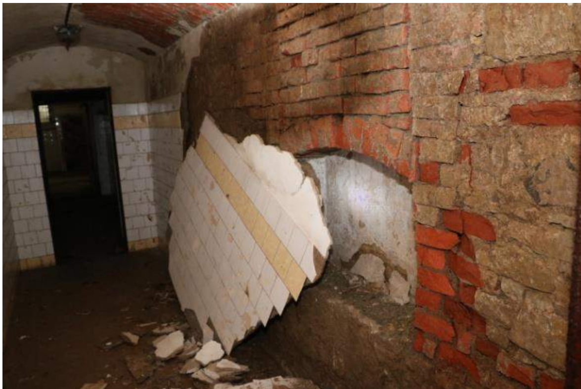
Odpadávající omítka a obklad odhalují původní skladbu zdiva
