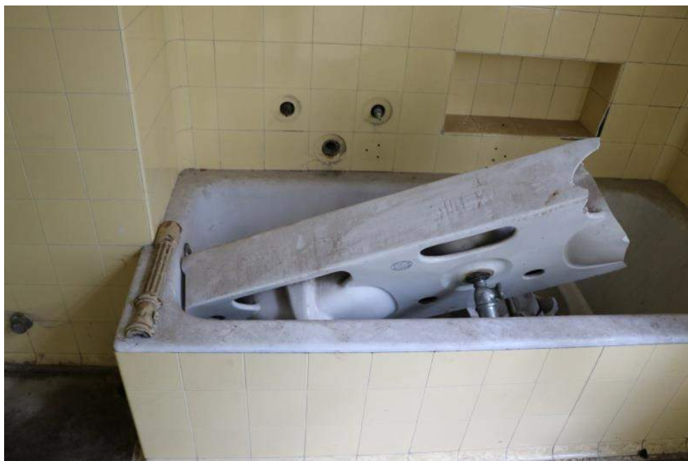
Koupelna - současný stav umyvadla
