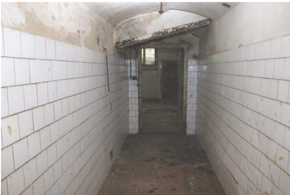
Odpadnutým obkladem a odvětráním hlavního sálu
