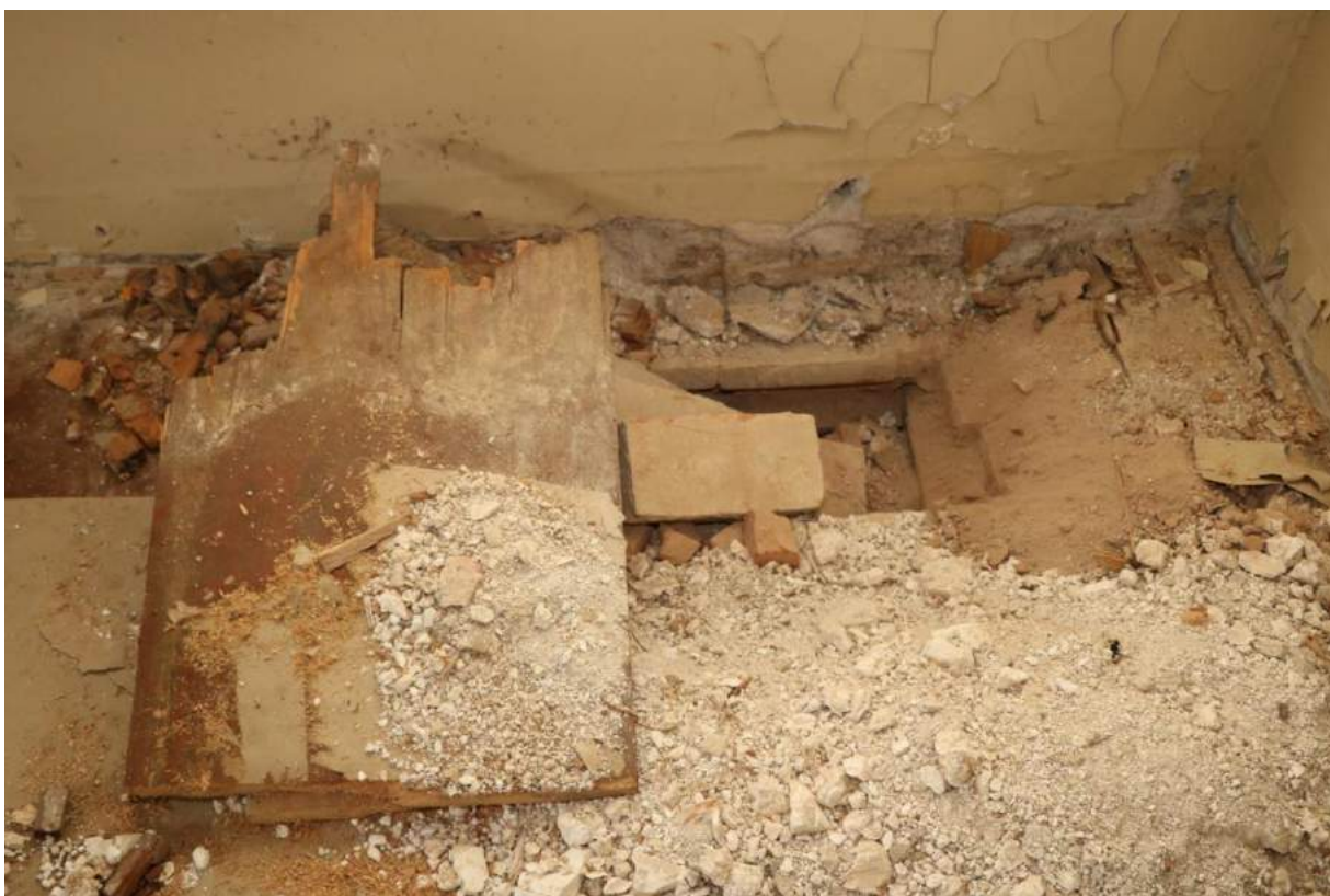
Rohový pokoj (Z) – poškozená podlaha
