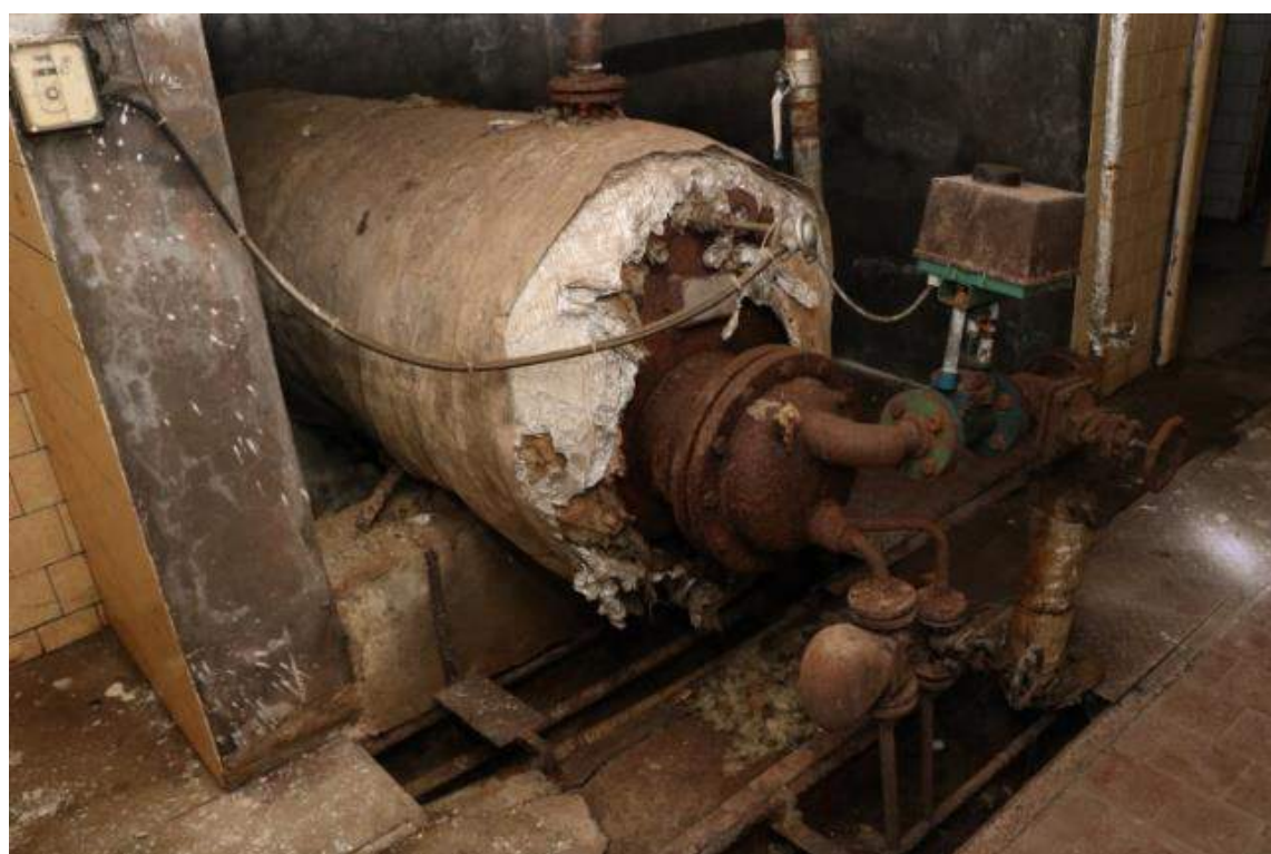
Kotelna pod schodištěm
