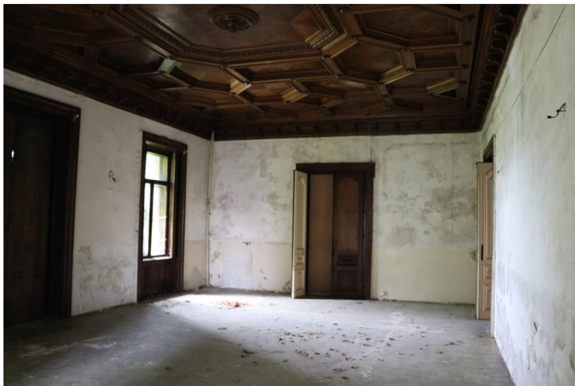
Jídelna - zazděné dveře do kabinetu, betonová podlaha
