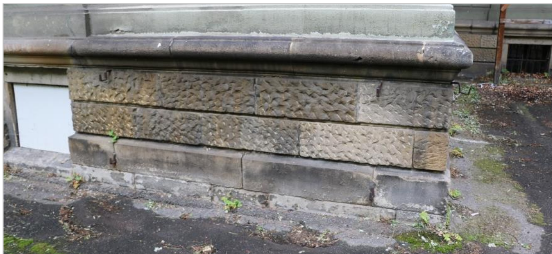
Kovové háky na treláže na kamenném soklu Asfalt až u zdiva, vzlínání vlhkosti
