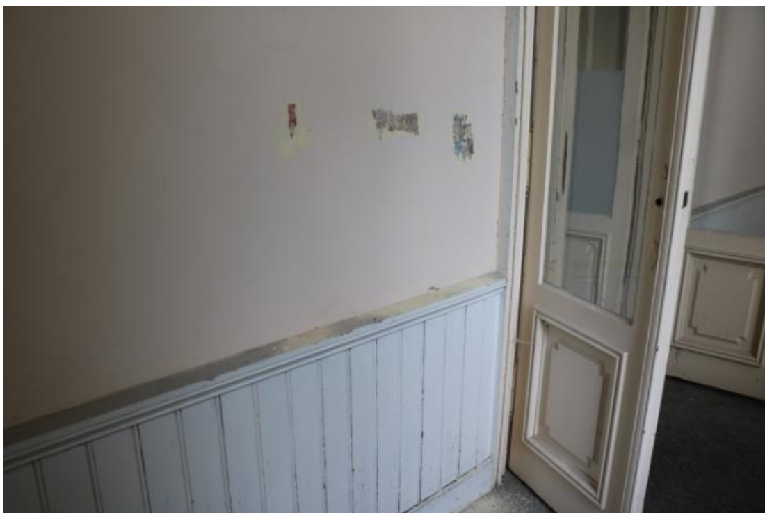
Lodžie - dřevěný obklad, pod nátěrem dekorativní nástěnné malby
