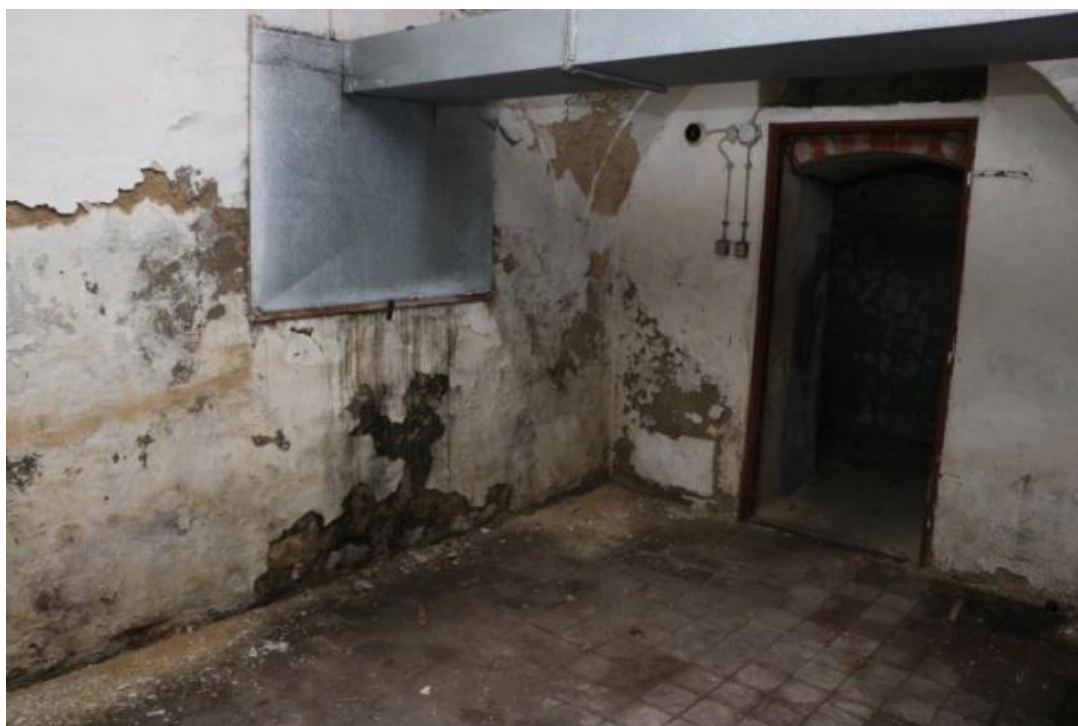
Malá společenská místnost (SZ) - s dveřmi do chodbičky a vzduchotechnikou z kotelny
