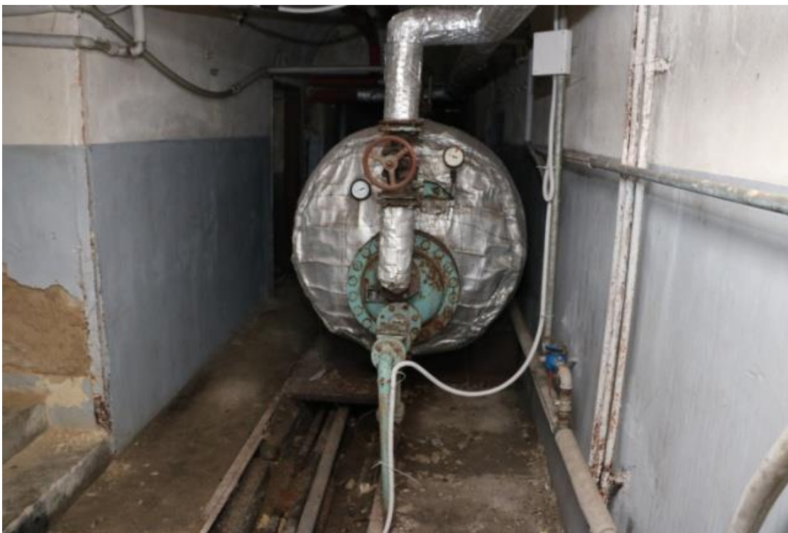
Chodba - rozvody, bojler
