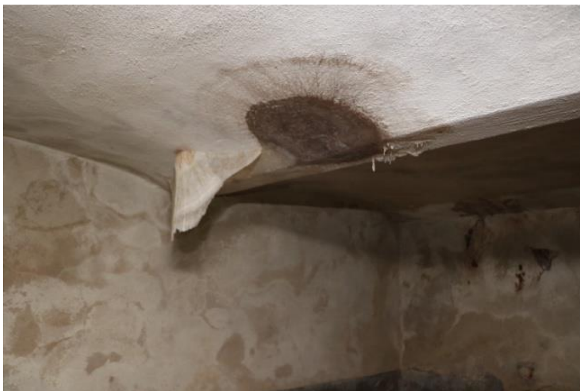
Prostor pod hlavním schodištěm - plísně a houba
