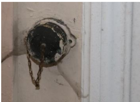
původní elektr.zásuvka s krytkou
