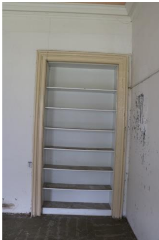
zazděné dvře z velkého pokoje (skříň)
