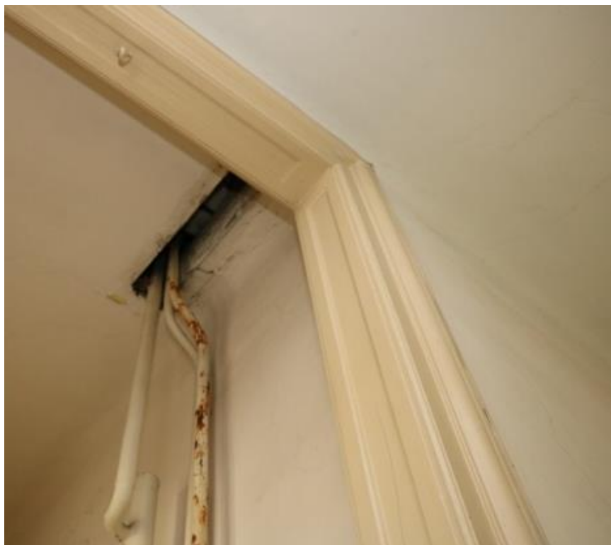
Rozvody u portálu
