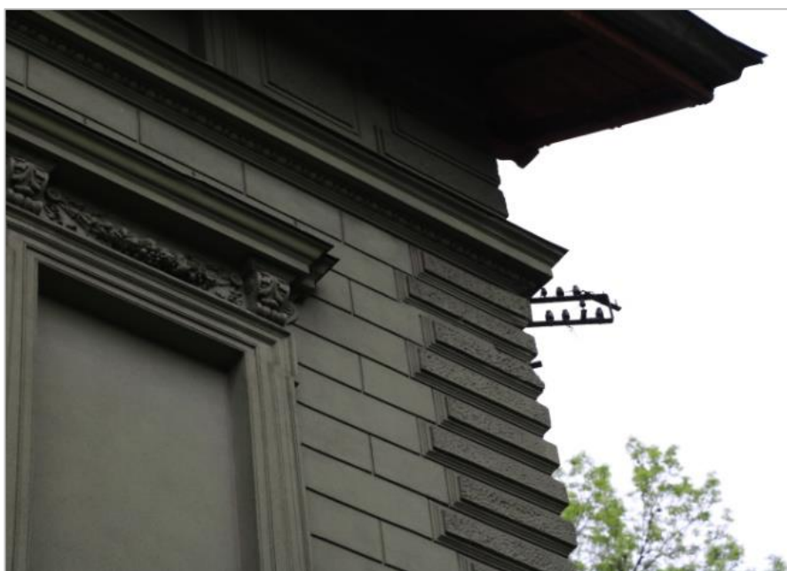
konzola na elektřinu na V nároží
