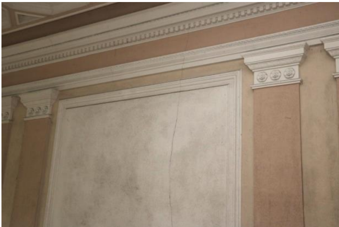
trhliny v obložení
