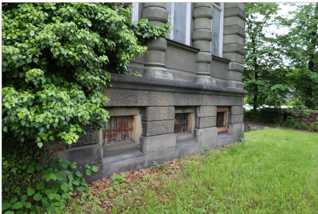
Zazděná okna v 1.NP, nad nimi okna v původně sloupové lodžii, chybí okapový chodník
